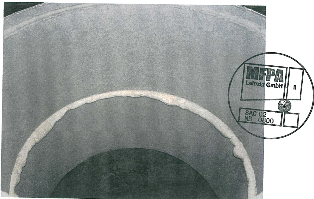
Bild 4: Ansicht der Verbindungsstelle der Schachtringe 24 Stunden nach Herstellung, Volumen des Schaumes hatte sich vergrößert
